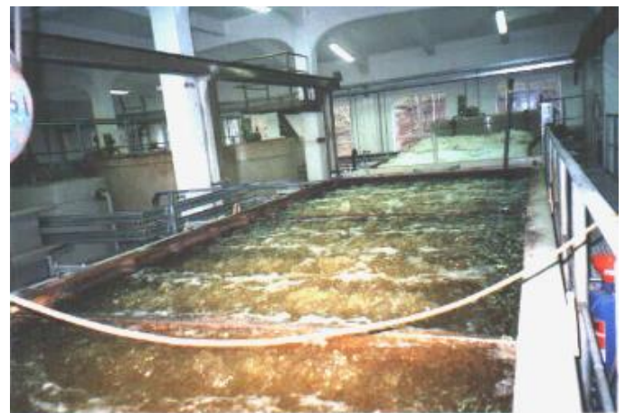
Festbett – Biologie für Deponie-sickerwasser entspr. 1000 EGW
