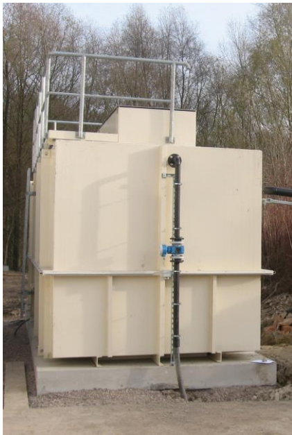
Anlagencontainer mit Festbett und Maschinenraum – zulaufseitig
