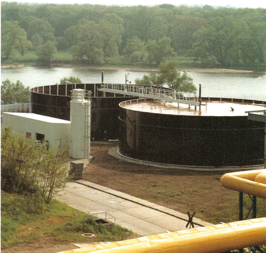
Außenansicht einer SBR-Biologie mit zwei Reaktorbehältern
