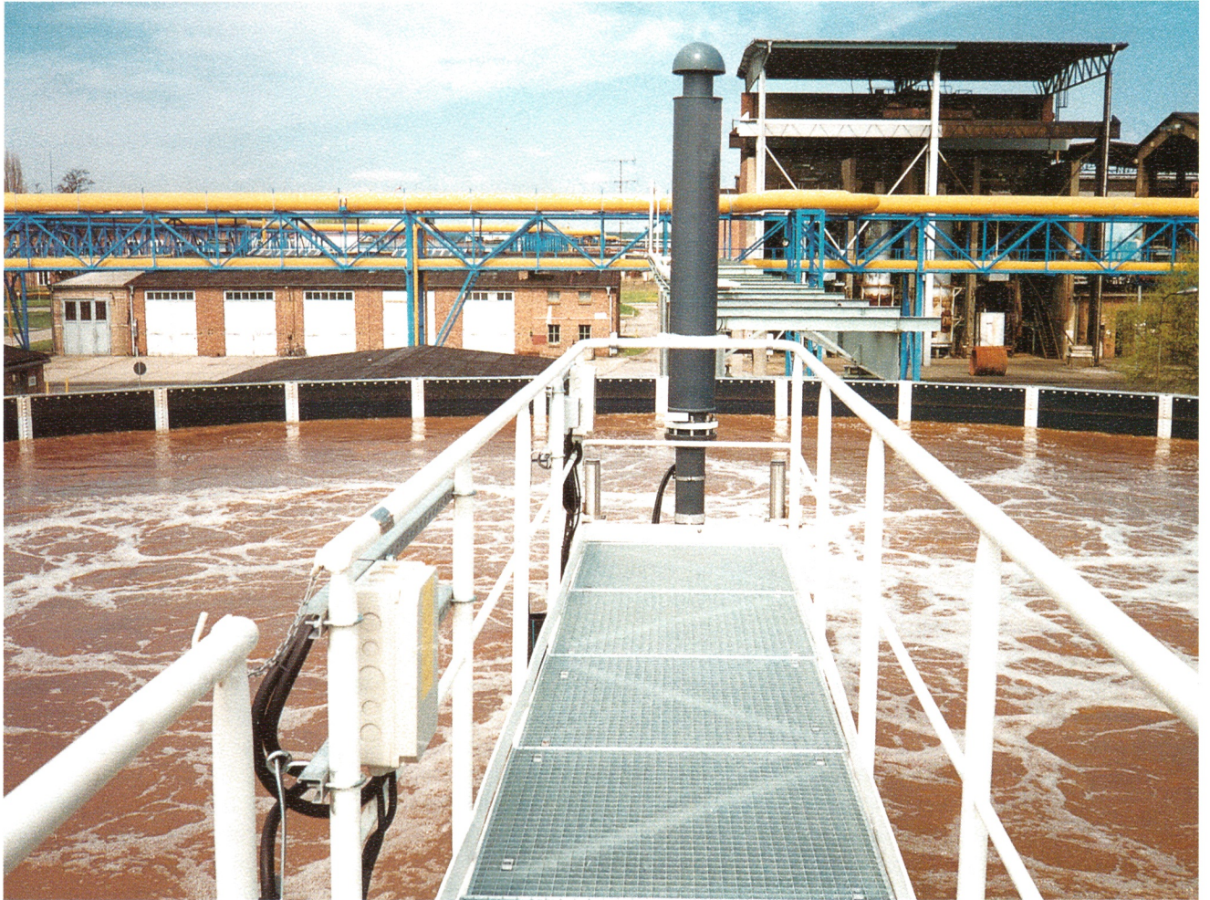
SBR-Biologie in der Belüftungsphase
